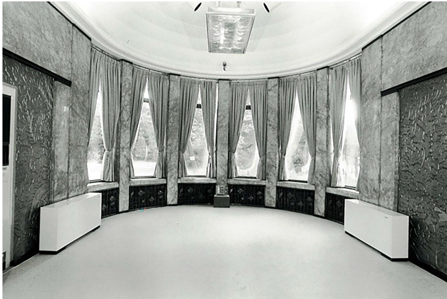
大食堂（1983年） 室内床置き型空調機（左右両側下部）と縦型空調機（左端）が見える
