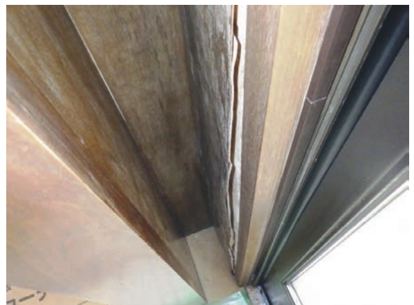
(2-1 写真16) 大広間カーテンボックスNo.3（修理前）
