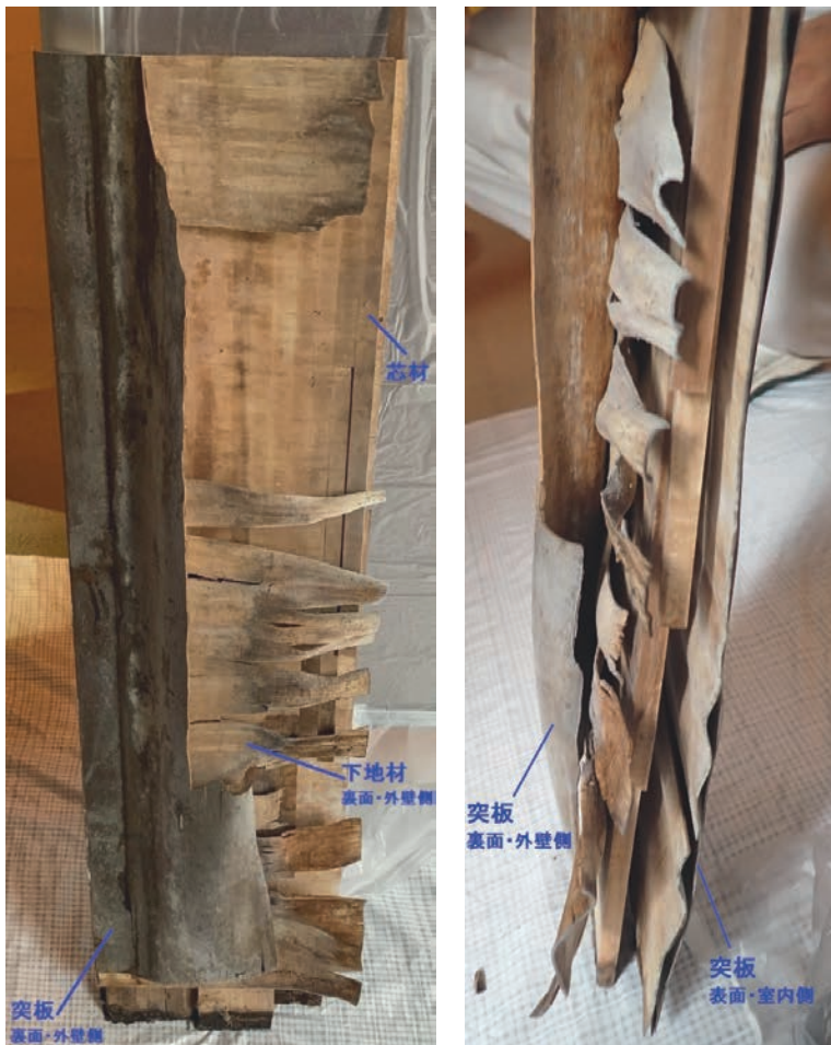
(2-3-表1 写真19・20) 2020(令和2)年度調査時に一部撤去したカーテンボックス合板
