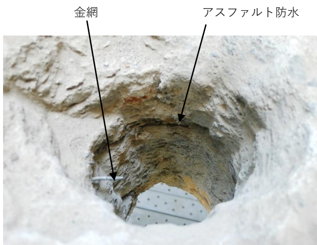
写真 2-1 浴室配管孔の断面 黒いアスファルト防水の層から金網の針金が見える。
