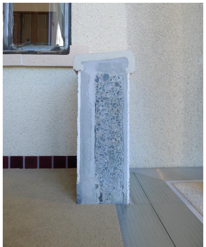
20 本館二階バルコニー躯体切断面（南側）
