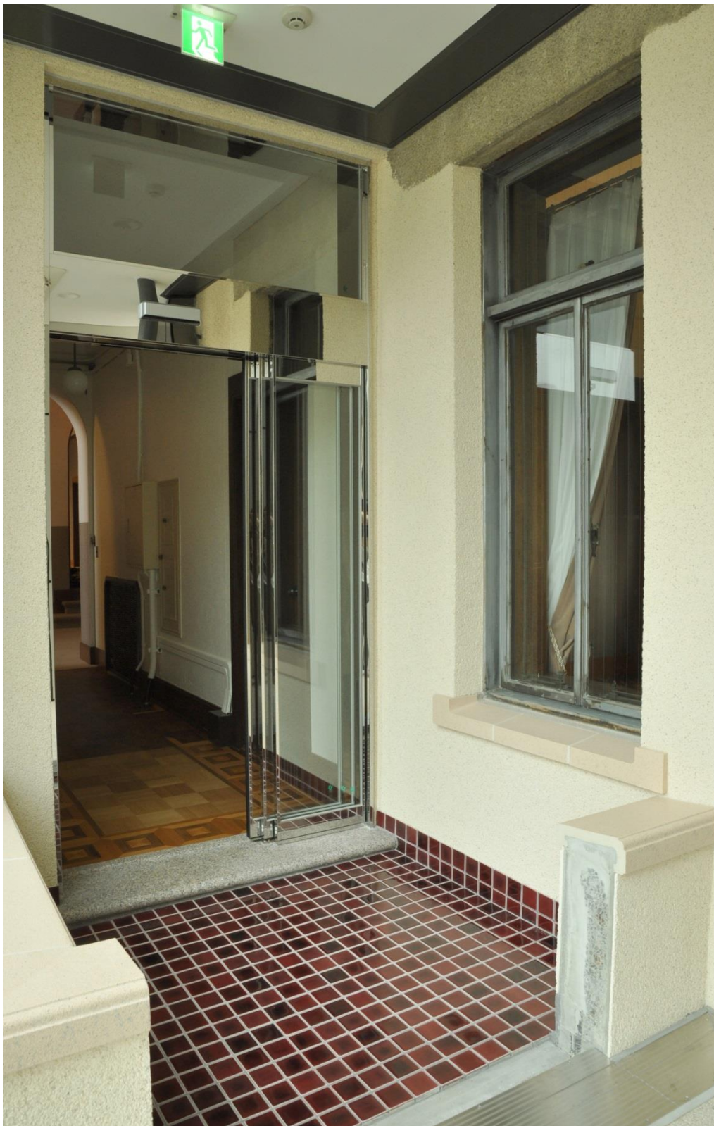
23 本館二階バルコニー全景（竣工） タイル貼、沓摺石、寄木貼を整備し、自動扉をカバー工法で設置した。
