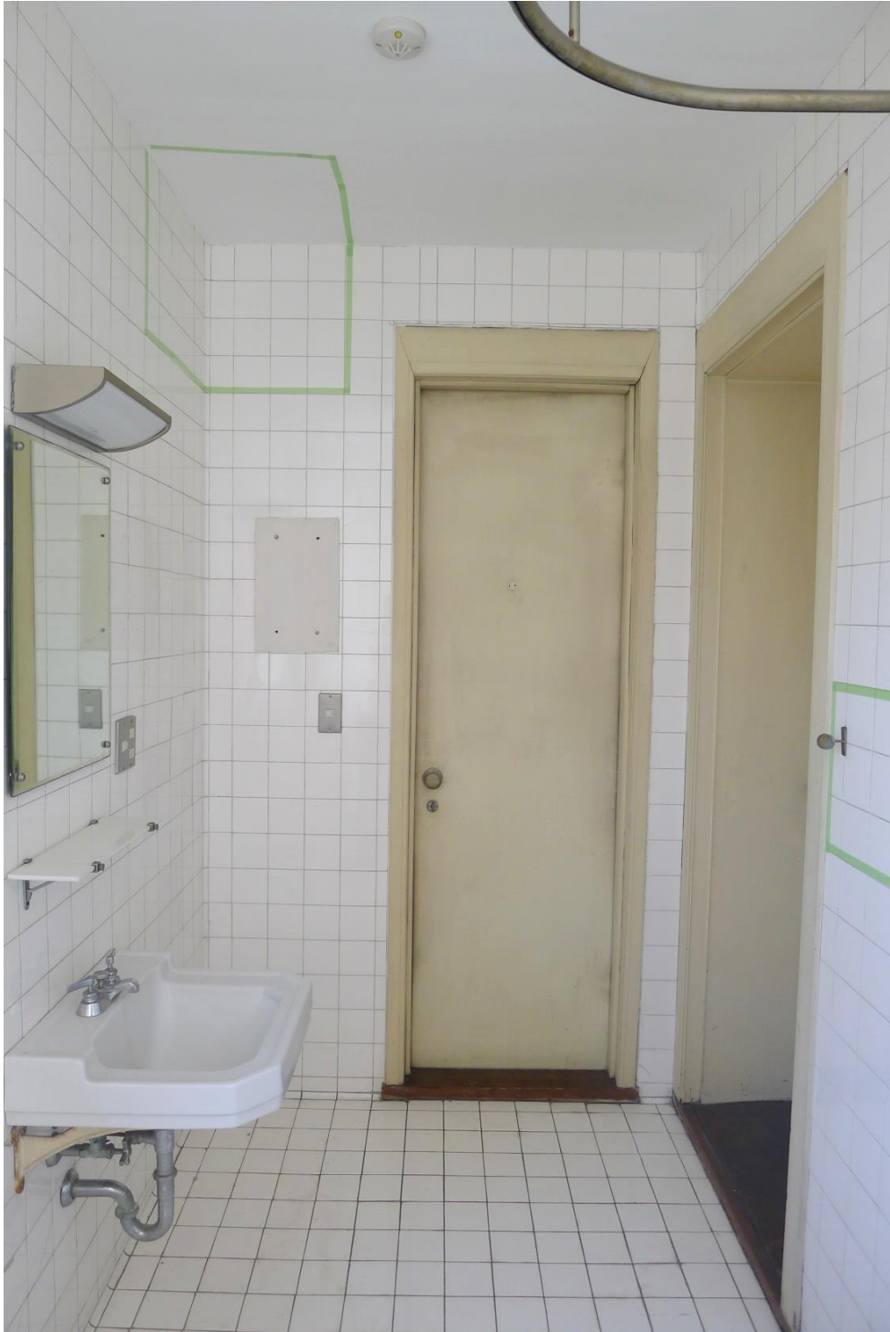
10 本館二階浴室（東面・修理前）
