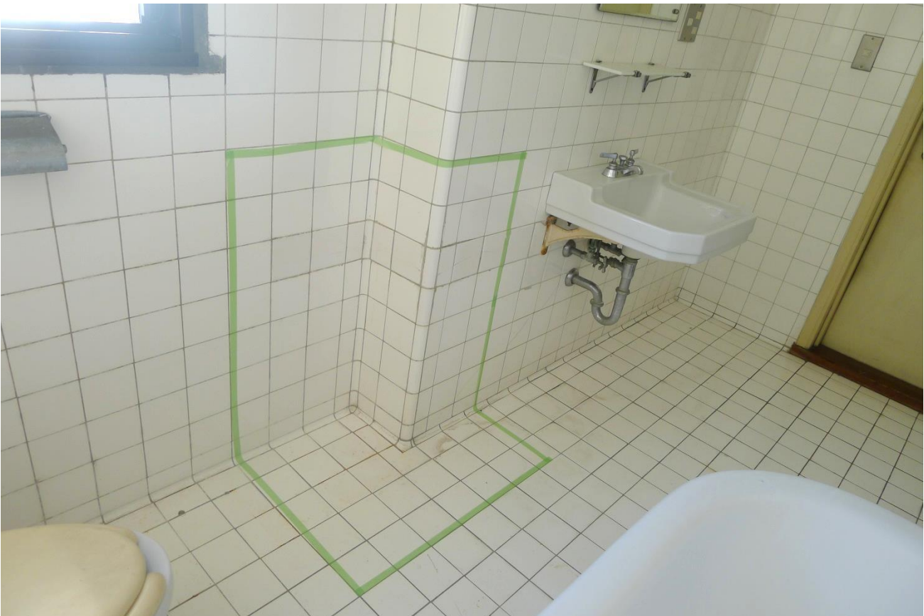
16 本館二階浴室（床面・修理前）
