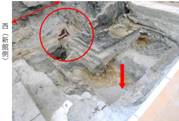
写真3-2 幅木タイル隅の納まり 本館側に幅木タイルが貼られている。 太矢印は石片残存箇所。
