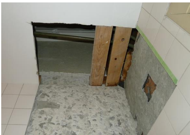
写真 7-1 浴室天井裏に残るラフコート塗
